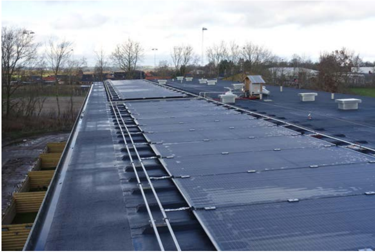
Solceller på vesthusenes tage
